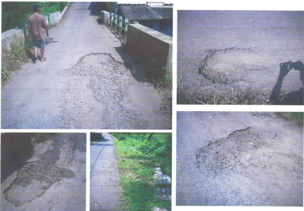
Gambar 2 Kerusakan di sekitar area jembatan
