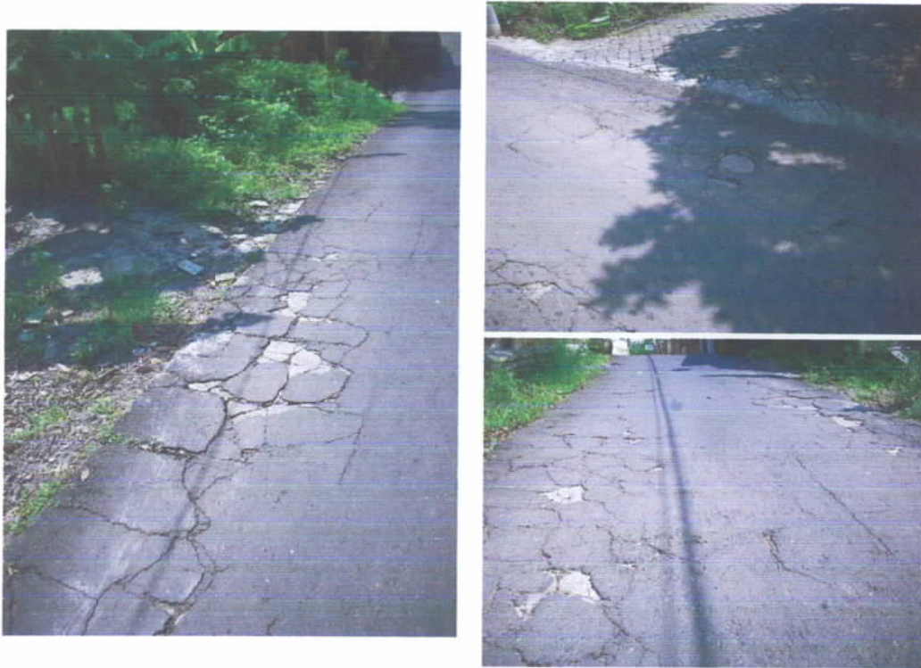
Gambar 1 Kerusakan di lokasi jalan menurun
