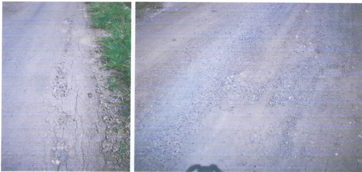
Gambar 3 Akibat tidak ada saluran irigasi jalan retak dan kotor sehingga rawan kecelakaan
